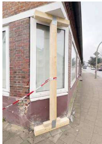
Das Haus musste durch einen Stützbalken gesichert werden.
