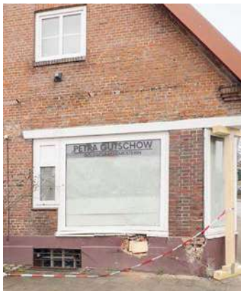
Ein altes Gebäude an der Dockenhudener Straße wurde durch einen Unfall erheblich beschädigt. Fotos: mk
