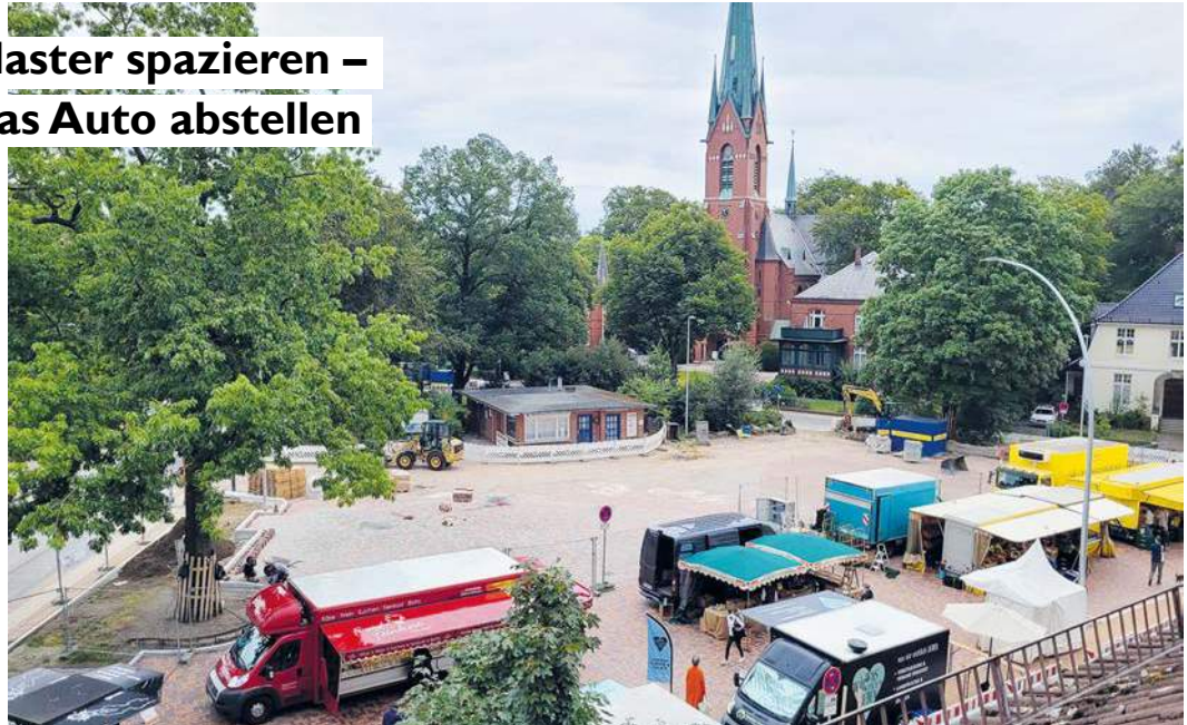
Auf dem bald fertig verlegten Pflaster dürfen keine Autos mehr abgestellt werden.
